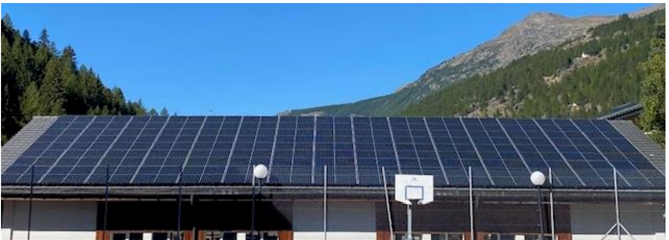
PV-Anlage auf dem Werkhof
